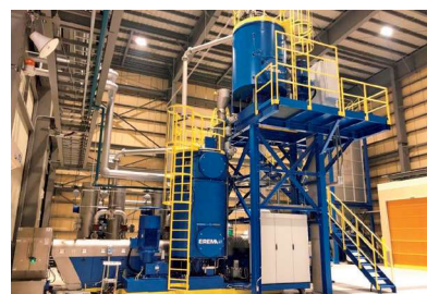
FtoPダイレクトリサイクル技術を採用したプラント
