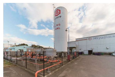
妙見工場に設置されたLNG貯蔵タンク
