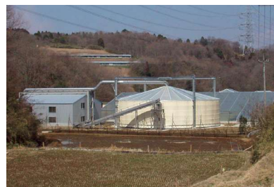
同社が栃木県茂木町「美土里館」に導入したプラント
