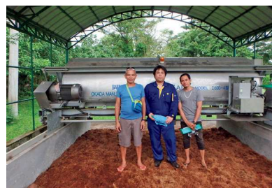
ルソン島レガスピにある生ごみ処理施設
