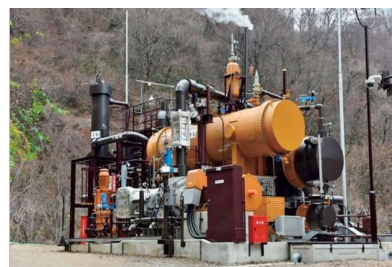
土湯温泉16号源泉バイナリー発電所
