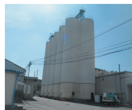
熊本地震で被害を受けたサイロ
