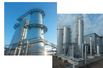
廃水を用いた燃料製造装置
