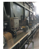
1度に12種類の原料配合が可能なプラント
