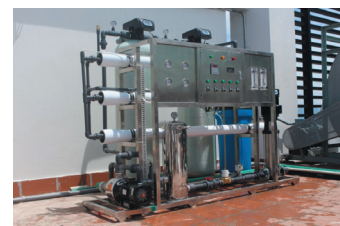
ホテル向け水処理設備
