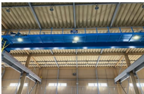
○天井クレーン
