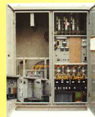
高圧受電設備
