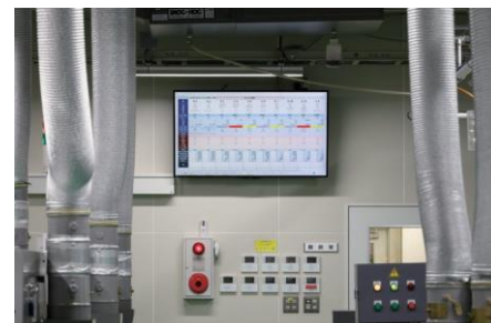
工場内モニタ(生産状況の可視化)
