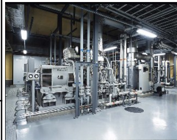
コージェネレーション設備
