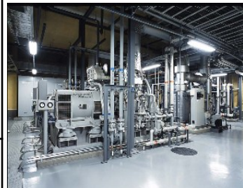
コージェネレーション設備
