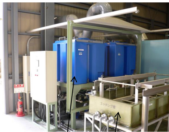
制御装置 エッチング槽
