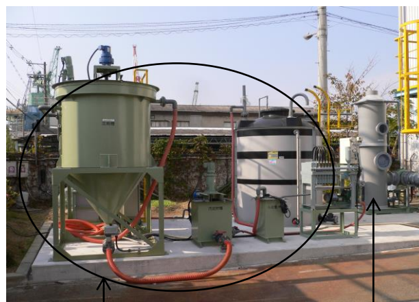
廃液処理装置 排ガス処理装置
