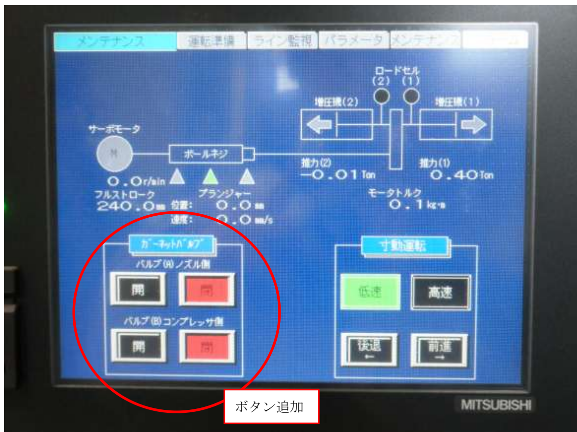
Fig. 65 WJ 制御盤 バルブ操作ボタン追加
