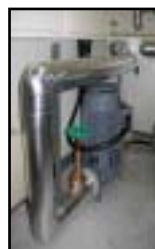
送水ポンプ (日立形)
