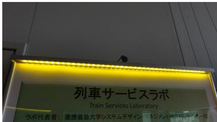
Fig. 4-6 案内板照明に応用した光変調照明
