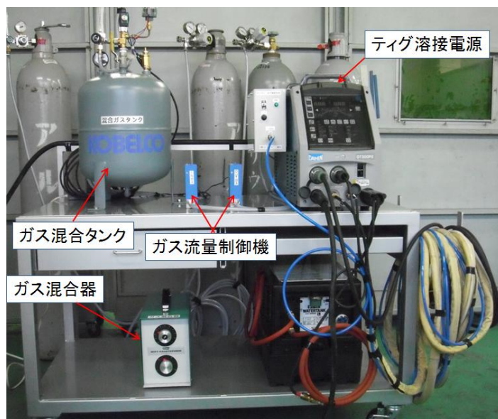
図 2-1 溶接電源及びガス混合装置の外観
