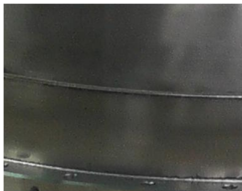
(b) ドーム部材と帯板の溶接部
