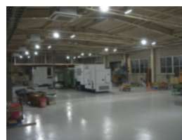
LED工場照明 (横15m×縦35m) LEDスクエアライト 90度拡散タイプ 24台設置
