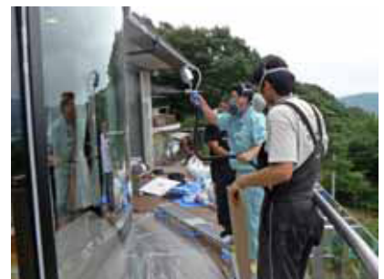
フミンコーティング風景 横10mの曲面ガラス 内側・外側施工が可能
