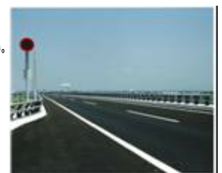
同社の防護柵が設置された高速道路
