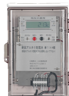
自動散水・止水制御装置
