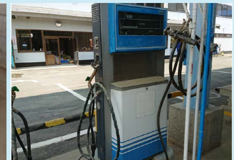
損壊したガスコンプレッサー
